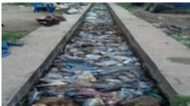
Figure 8. Mauvaise gestion des caniveaux : canal rempli de déchets en plastique.
