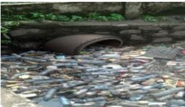
Figure 9. Mauvaise gestion des caniveaux : buse presque bouchée avec des déchets en plastique.
